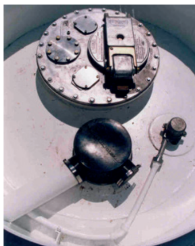
Figura 5. Escotilla con tapa de inspección cerrada, sensor de nivel y recuperación de gases
