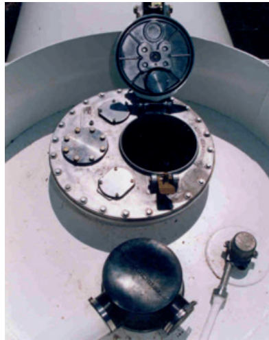
Figura 6. Escotilla con tapa de inspección abierta donde se observa la válvula de seguridad en la tapa
