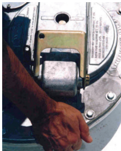
Figura 7. Accionamiento para apertura de tapa de inspección
